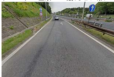
舗装損傷状況
