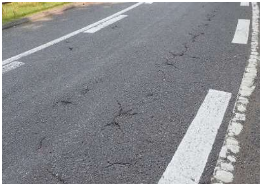
舗装損傷状況
