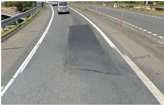
舗装損傷状況
